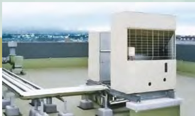
● 屋外機とラッキング冷媒配管
