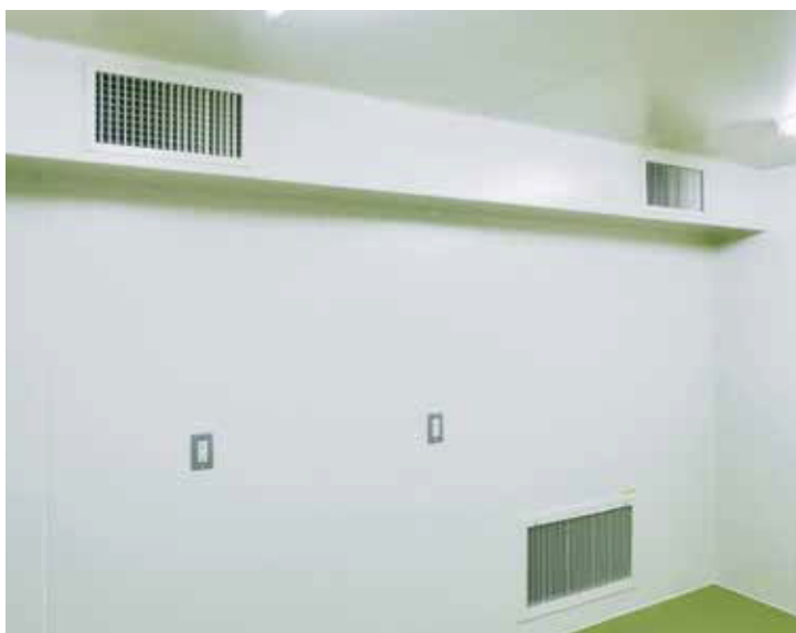
● 恒温恒湿室内部
