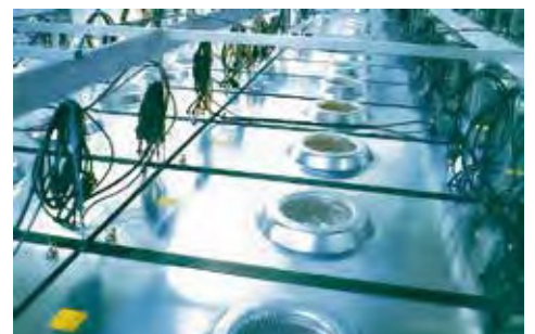
● システム天井内クリーンユニット
